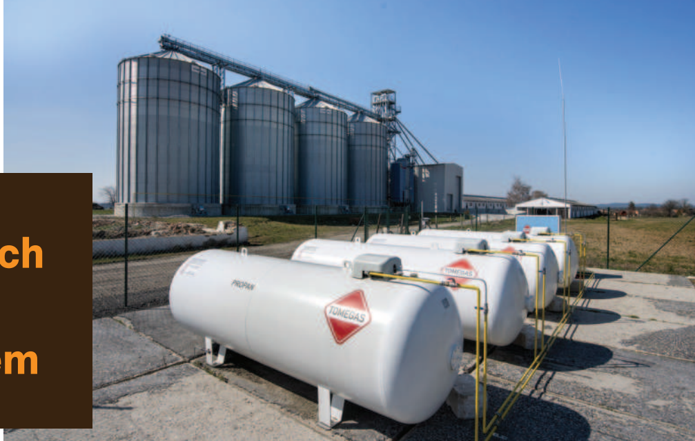
Obr.: Ke skladování propanu slouží 4 zásobníky o objemu 4,2 m 3
