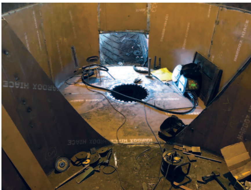
Obr.: Vnitřní vyložení z oceli Hardox HiAce bylo vyrobeno firmou Gama Ocel v polovině roku 2020. Po 18 měsících provozu činil úbytek materiálu na nejvíce exponovaných místech 1–1,5 mm.
